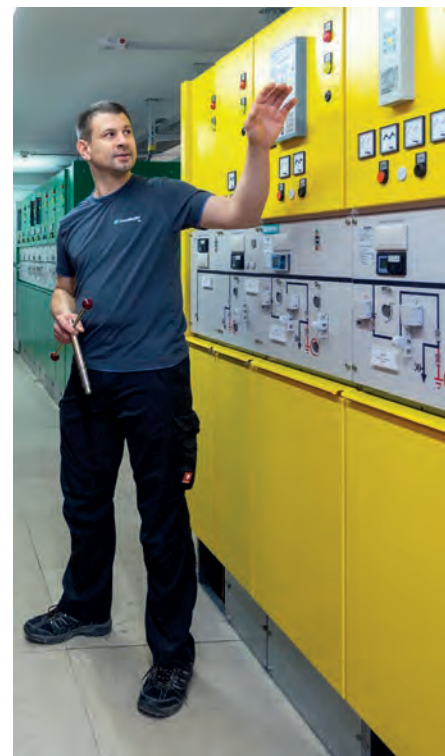
Mittelspannungsschaltanlage im Zentrum für Leistungselektronik und nachhaltige Netze.
